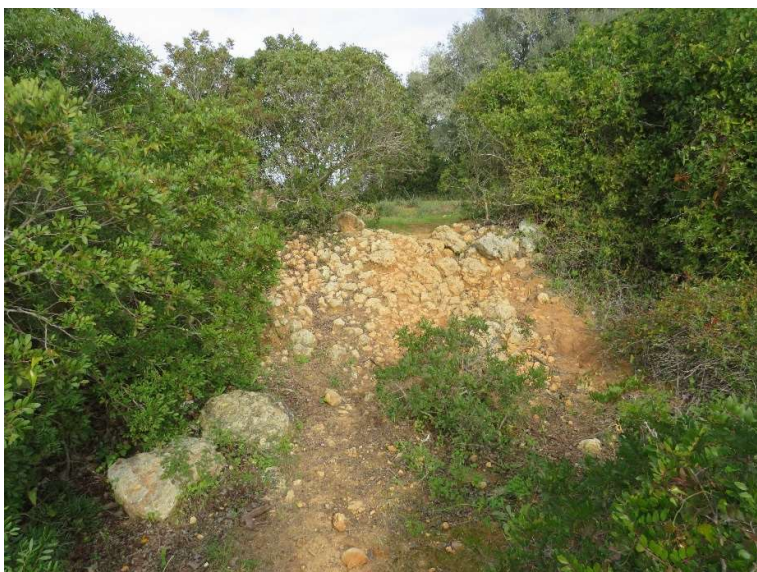
Figura 7. Vale de Engenho 1. Muro de contenção de talude, em ruína.
