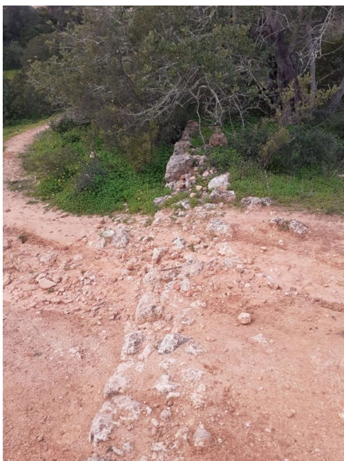
Figura 78. Ocorrência 4: Vale de Engenho 3.
